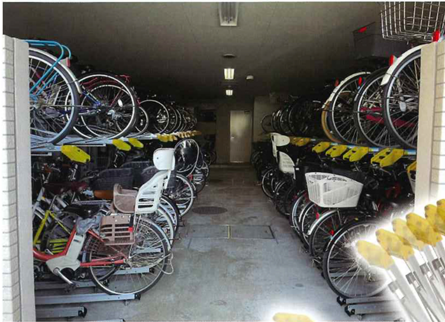
東京・板橋区のマンションに設置された AFS垂直2段式ラック
